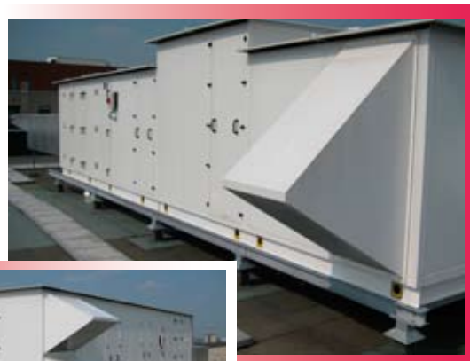
HC TN luchtbehandelingkast met verhoogde warmtewielsectie
